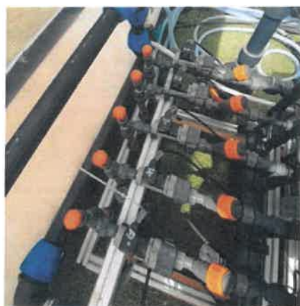
Foto 2 Particolare delle linee dedicate alla fertirrigazione
